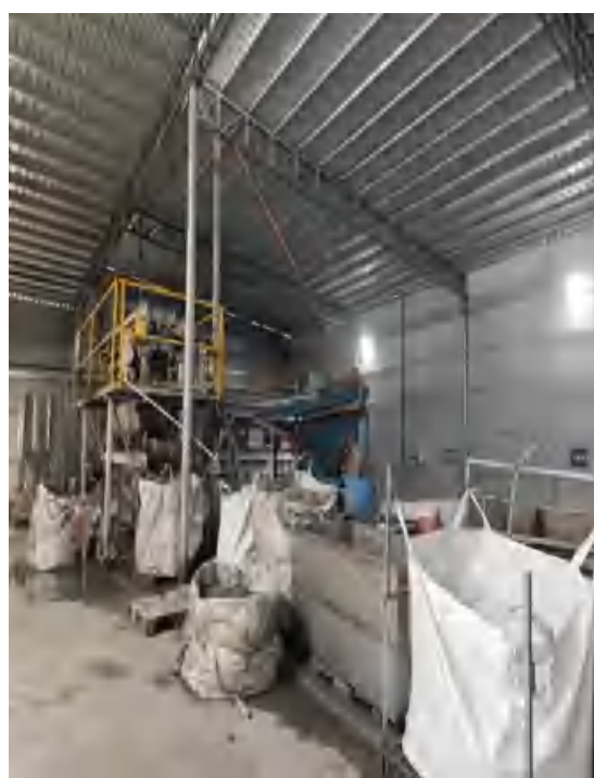
废水处理工艺设施
