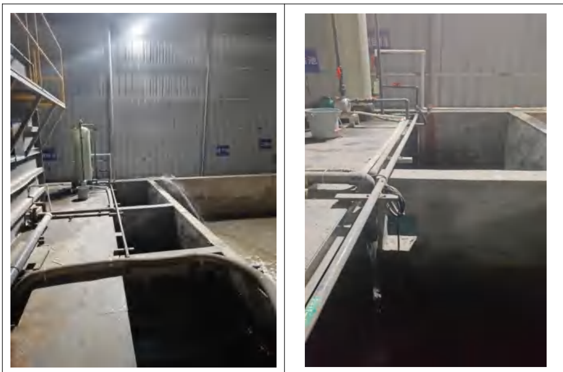
废水处理设施
