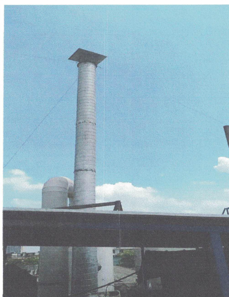
酸雾废气排气筒
